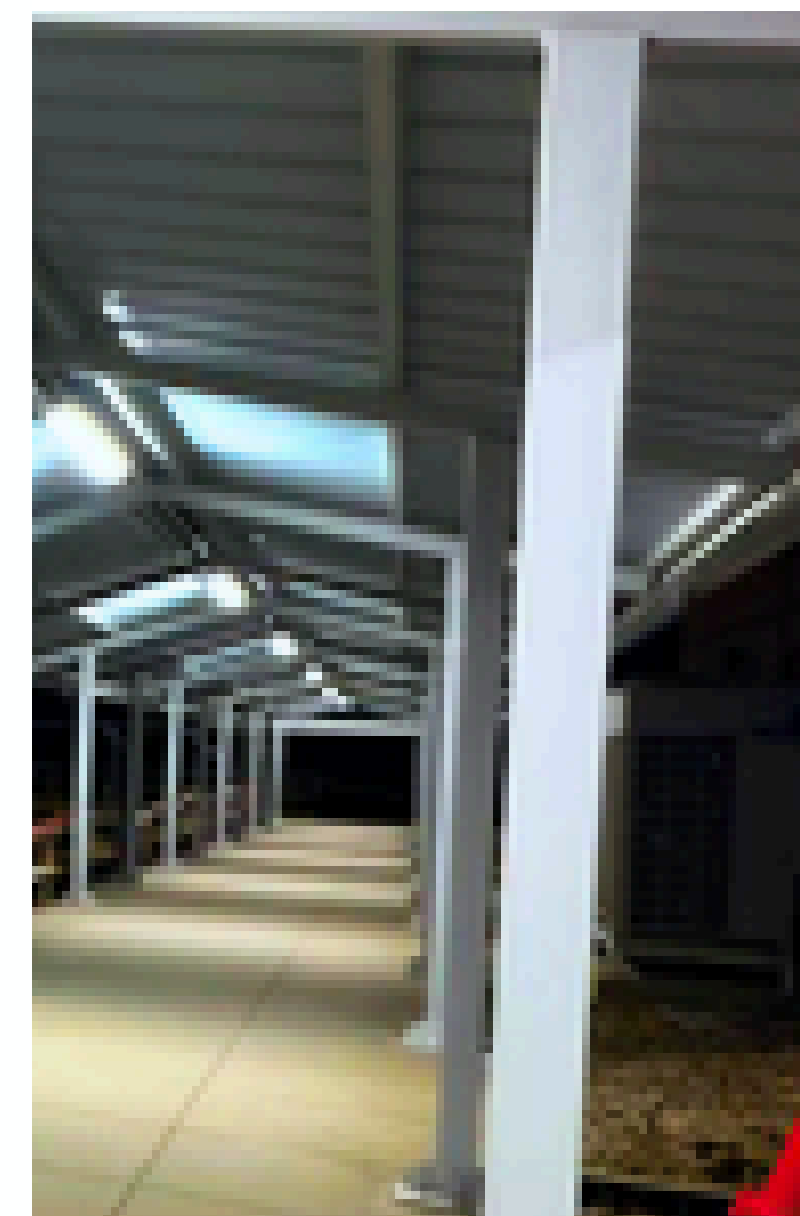
DISEÑO, SUMINISTRO E INSTALACIÓN DE TECHOS AL INGRESO DEL COMEDOR - CAMPAMENTO KM 52 (2023)
